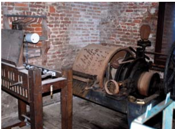
Het klavier en trommelspelwerk uit 1927. Links in de muur achter de gevelopening is de motor van het uurwerk opgesteld. Een kleine elektrische servomotor ter grootte van een conservenblik drijft de wijzers aan.
